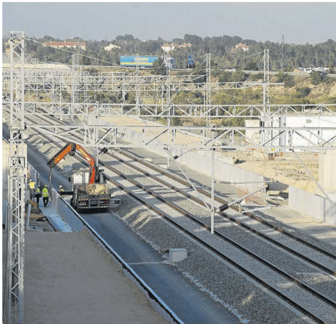
Obras del Corredor Mediterrani en la zona de Cambrils, en una imagen de archivo. FOTO: JOAN REVILLAS
